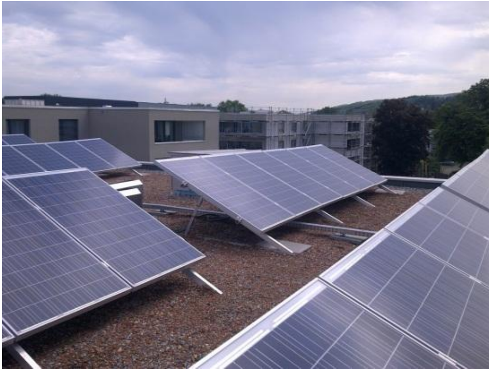
Abbildung 2: KEV-Solarstromanlage Schmidgasse in Frauenfeld
